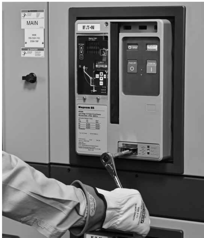
Levering Magnum DS breaker
